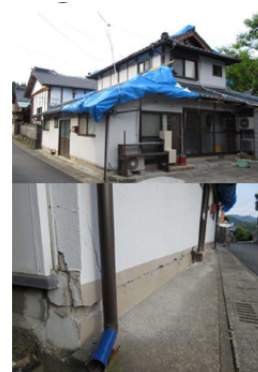
図6 小谷地区の建物被害
